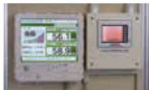
▲デマンド監視装置
