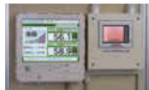
▲デマンド監視装置
